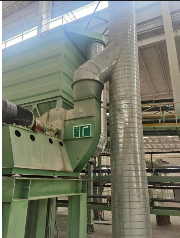
DA004 号排气筒
