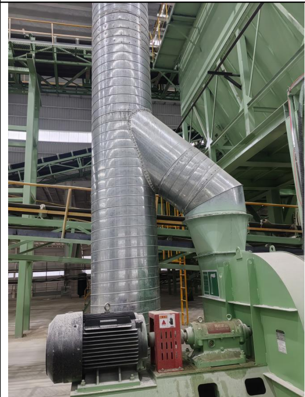
DA002 号排气筒
