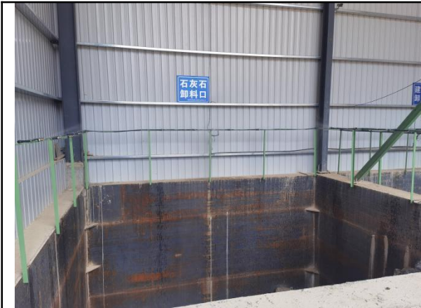
石灰石卸料口水喷淋
