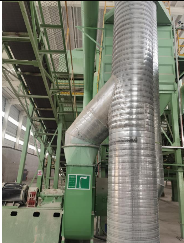
DA005 号排气筒
