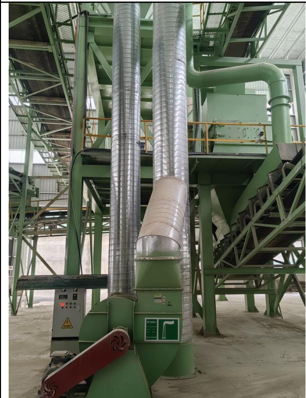
DA001 号排气筒
