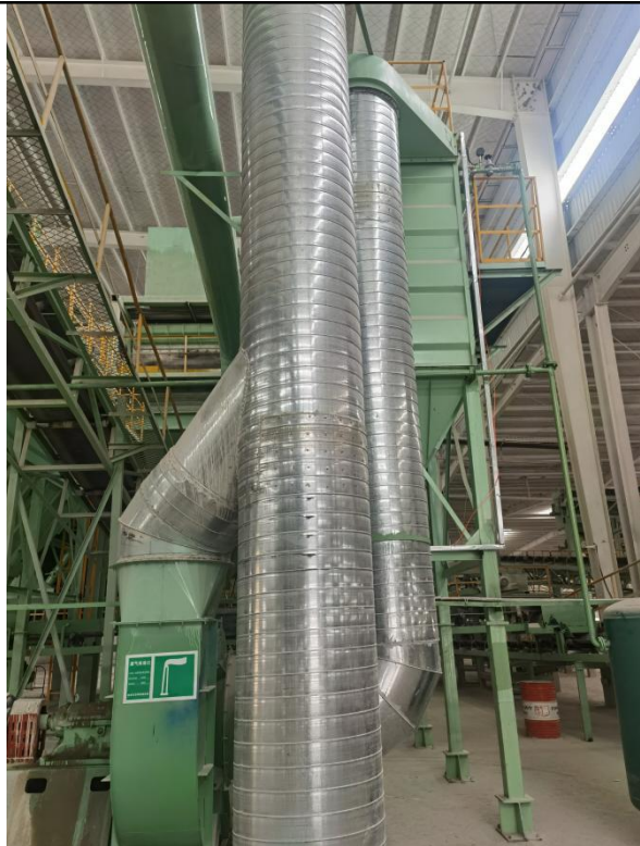
DA006 号排气筒
