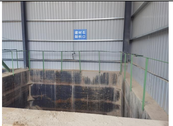
建筑石料卸料口水喷淋
