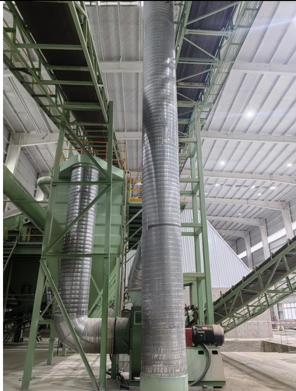
DA003 号排气筒
